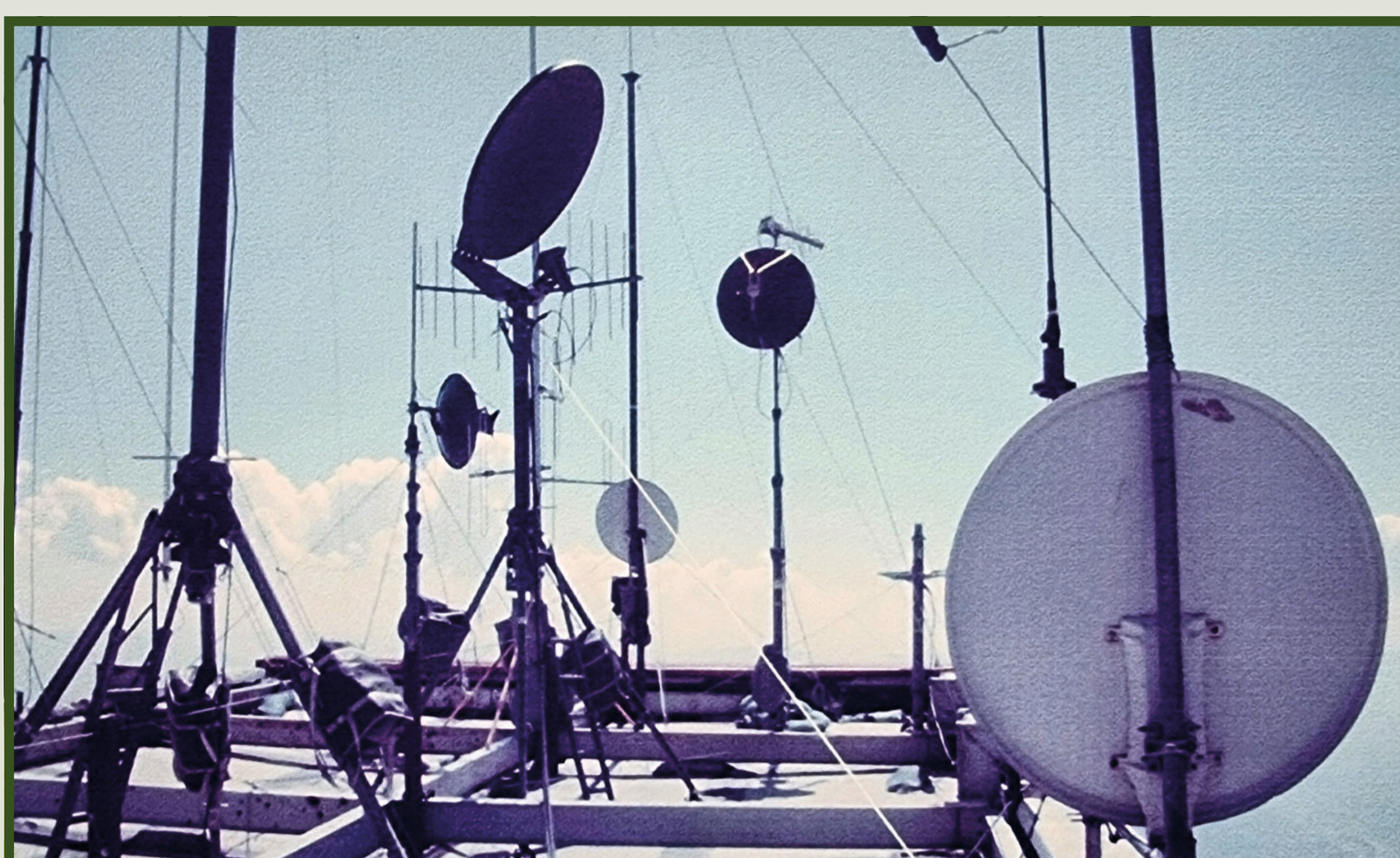
Antennenfeld beim SFOR-Einsatz auf dem Zortaci
