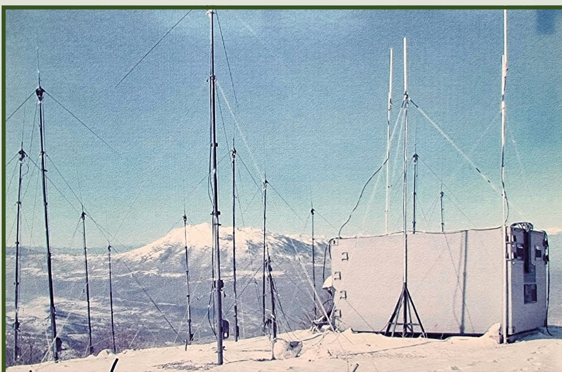
Das von der Fernmeldetruppe errichtete und unterhaltene Antennenfeld auf dem Civilien
