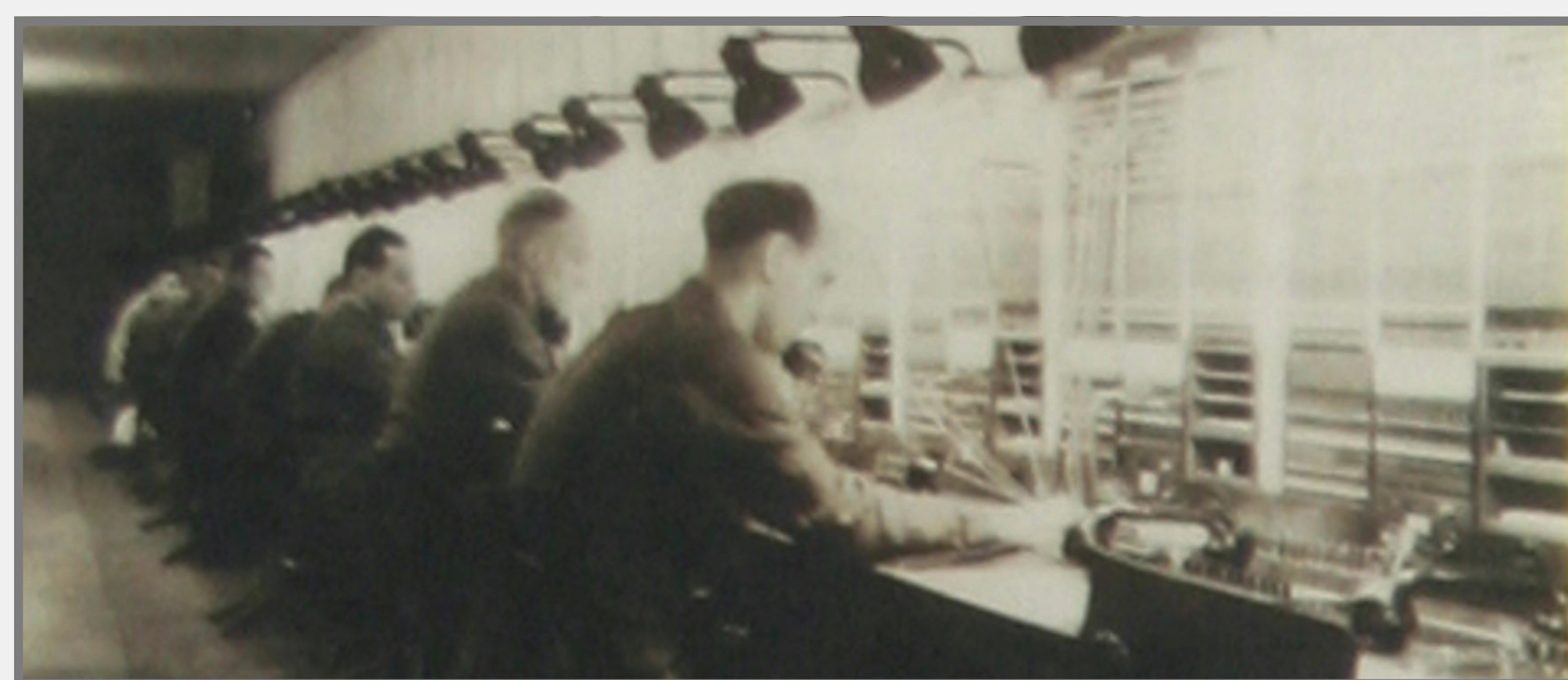
Fernsprech-Fernvermittlung im Nachrichtenbunker „Zeppelin“ in Zossen
